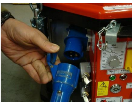
電源ケーブルを抜く
