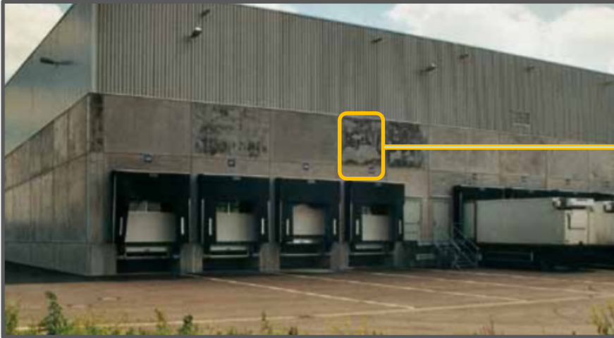
腐食の起きたコンクリート外壁
