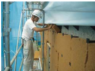
ホームテルムの木質断熱材 10cm厚の断熱材を外側から施工
