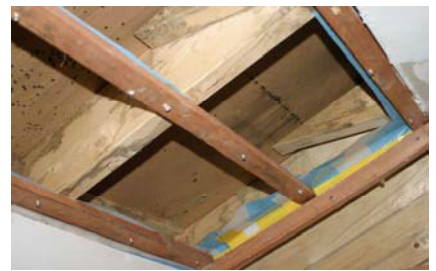
ポリエチレンシート(青色)の内部で発生したカビ
