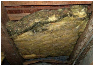
結露によるカビの被害
