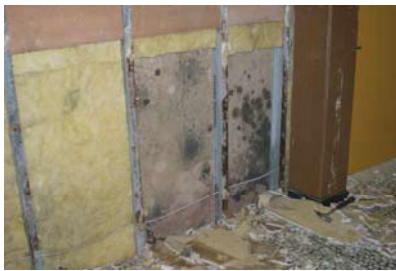
カビだらけの石膏ボードと断熱材
